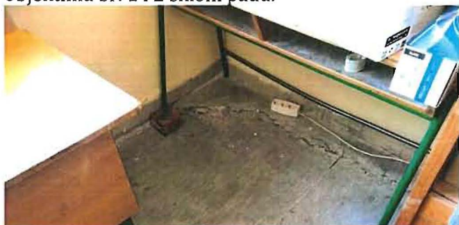
Slika 1. Pukotine u podnoj ploči i fasadnim nosećim zidovima na uglu objekta br. 2.
